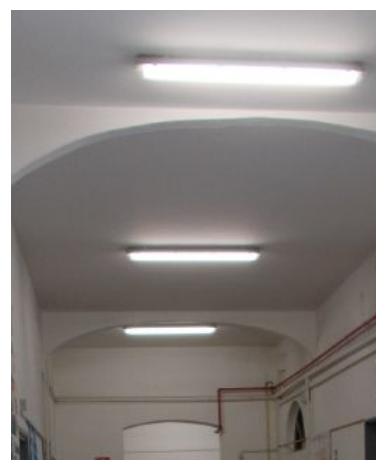
Figura 8.7 – Particolare di un corpo illuminante
