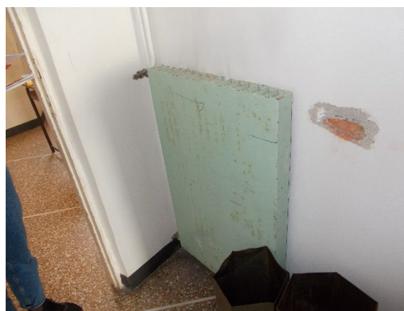
Figura 4.7 - Particolare dei radiatori
