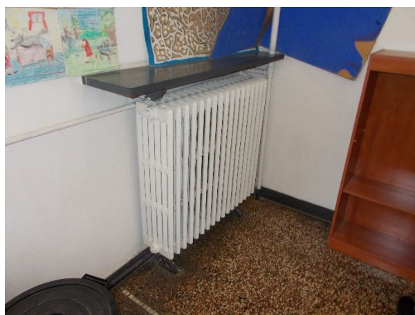
Figura 4.6 – Particolare dei radiatori
